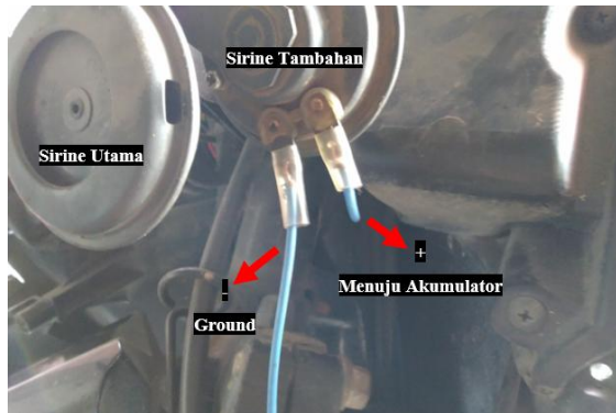
Gambar 8. Sirkuit pemasangan sirine tambahan.
